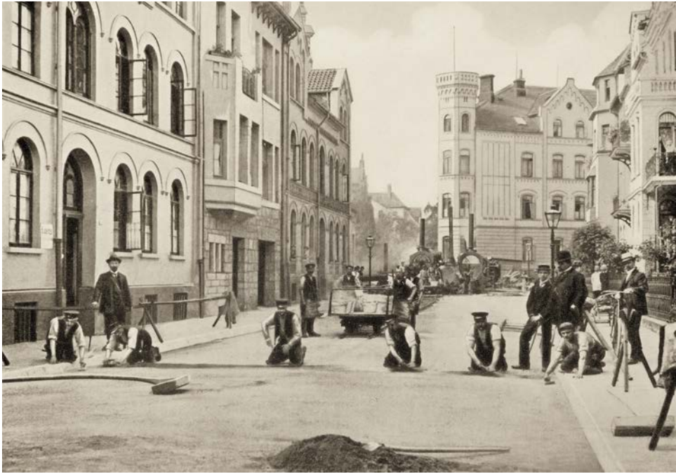
Abb. 26 Herstellung von Hartgussasphalt auf Betonunterlage in der Straße Am Emmerberge in Hannover 1909. Aus DASAG (1926).
